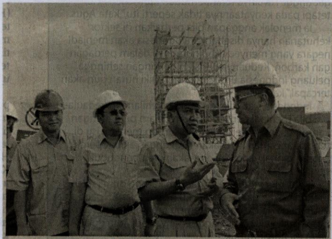
PEMBANGKIT LISTRIK BARU : Direktur Utama PT Perusahaan Listrik Negara (PLN) Fahmi Mochtar, tengah menanyakan progress proyek pembangunan PLTU 2 Jatim Paiton Baru kepada GM Pembangkitan Indramayu, Awar-Awar, dan Paiton Eko Soedartanto Aris (dua dari kiri). Ikut dalam rombongan Vice President Pelayanan Konstruksi IPP Monang M.T. Sirumapea (paling kiri) dan GM PT PLN Distribusi Jawa Timur Budi Harsono (dua dari kanan) di Paiton, Senin (12/1). Proyek berkapasitas 1X660 MW yang dibangun pada 12 Maret 2007 diharapkan beroperasi komersial pada 12 Maret 2010 dan menambah pasokan listrik Jawa dan Bali.
